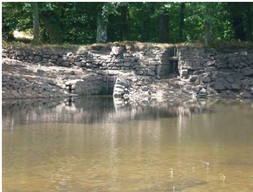
Figure 45 : Vue des vannes hautes et basses insérées dans la digue du Petit étang des Chênes (été 2020)
