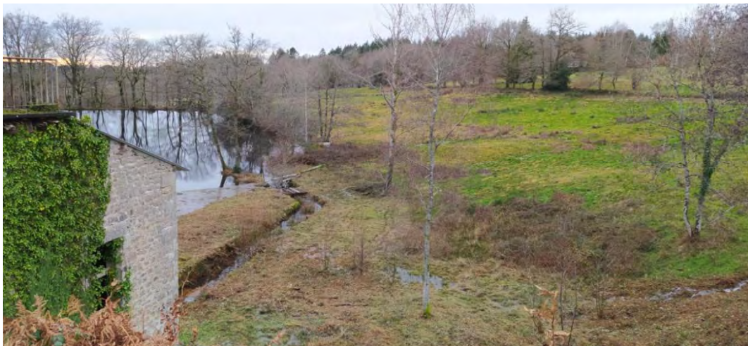
Figure 44 : Canal maçonné d'évacuation des eaux de l'étang des Chênes vers le Petit étang des Chênes
