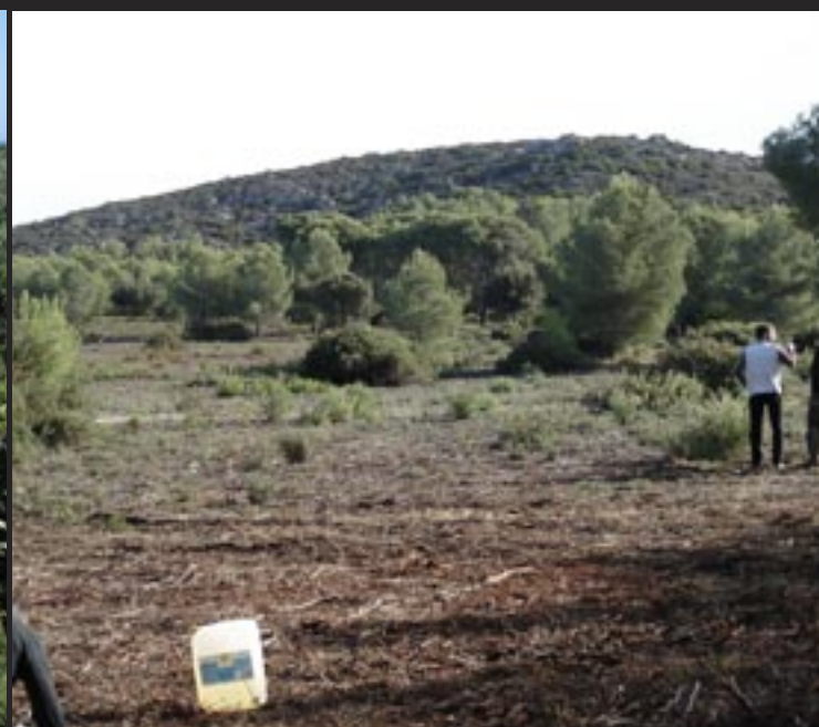
Saleccia : création d'une zone pastorale clôturée en arrière de la pinède, pour servir de pare-feu
