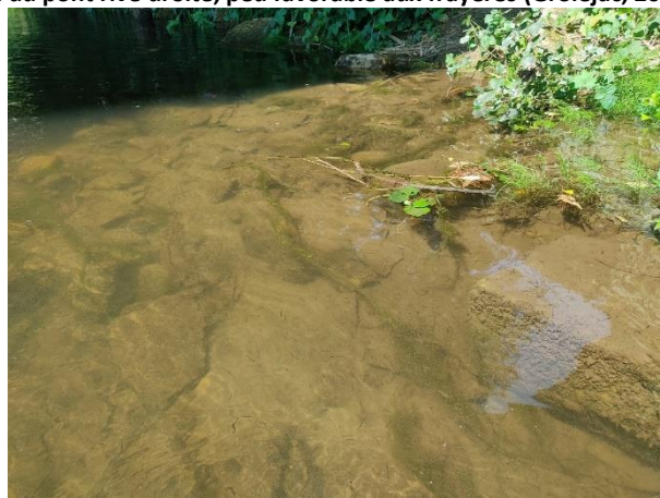
Figure 24 : Enrochement au pied du pont rive droite peu favorable aux frayères (Groléjac, 2022) © ETEN Environnement
