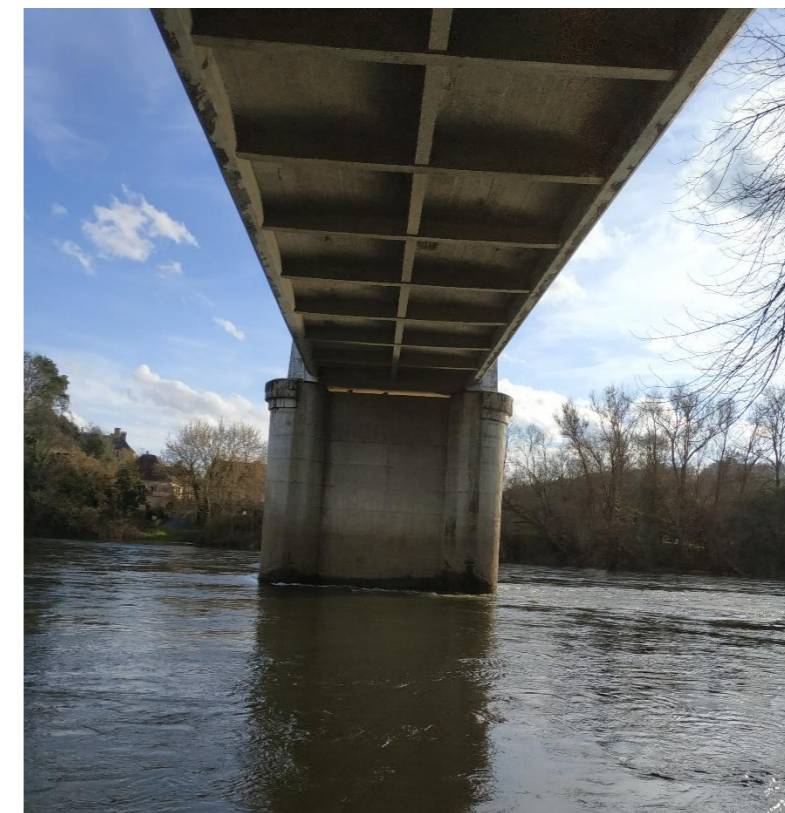
Pile du pont au sein de la rivière Dordogne (source : CERMECO)
