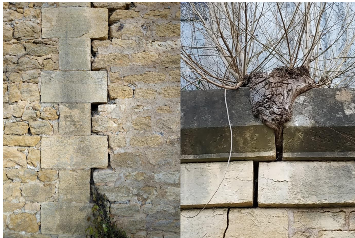
Illustration de disjonctements et de pousse de végétation au niveau de l'ouvrage d'art (source : CERMECO)
