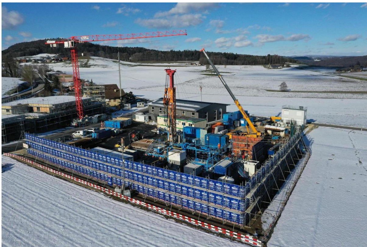
Figure 24 : Exemple d'installation similaire (forage Stadel-2, source : Daldrup)
