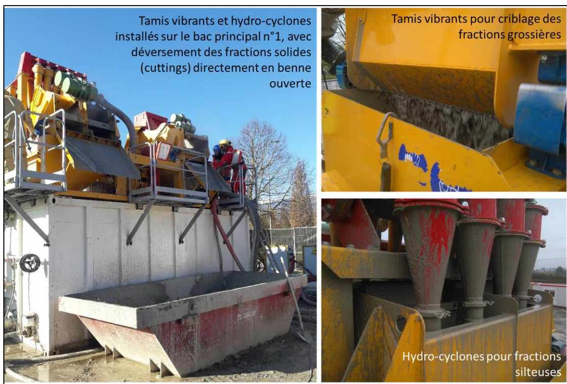
Figure 11 . Système de traitement des boues via des tamis vibrants et hydro-cyclones. d'éliminer les déblais de la boue (scalpage à 5 mm, essorage à 400 \mu m et désiltage à 100 \mu m) pour permettre une réutilisation du fluide en circuit fermé.
