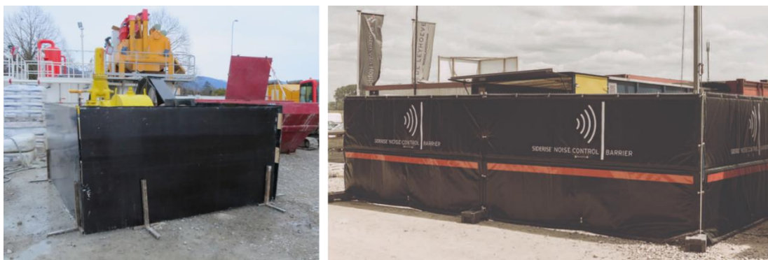
Figure 30 : Photo de gauche : panneaux métalliques déployés autour de la pompe à boue de Géo-01; Photo de droite ; exemple de bâches acoustiques qui seront déployées autour des machines les plus bruyantes.
