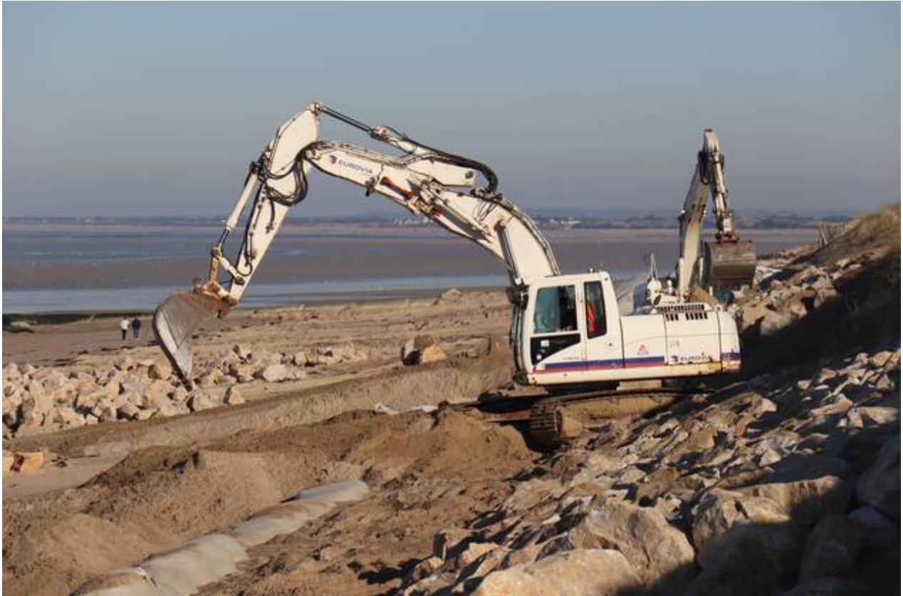
L'enrochement devant la dune de Gouville est en cours depuis quelques jours. | OUEST-FRANCE
