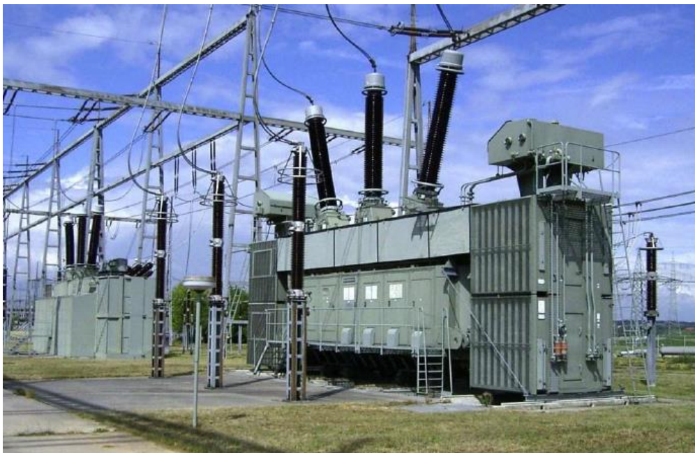
Exemple de transformateur
