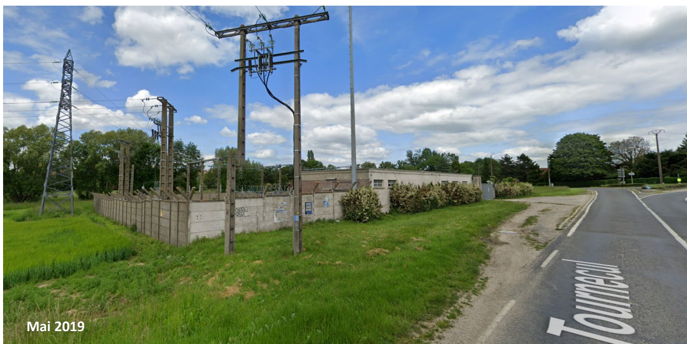
Vue sur le poste en arrivant de l'ouest par la RD 310
