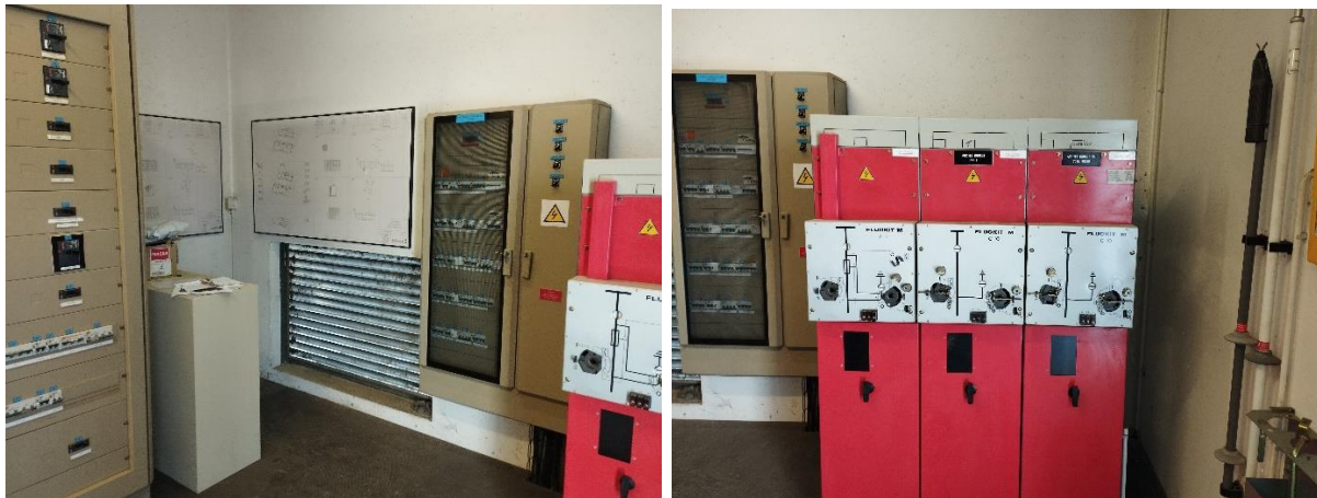
Figure 30 Poste de transformation U
