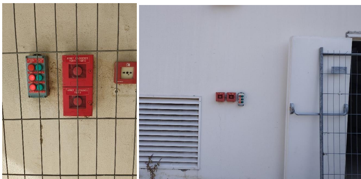
Figure 23 Arrêts d'urgences Réseau - Côté Nord et Sud – Zone 2
