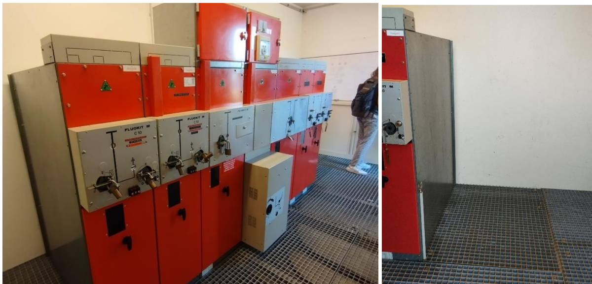
Figure 26 Poste de livraison - Raccordement HTA Zone 1
