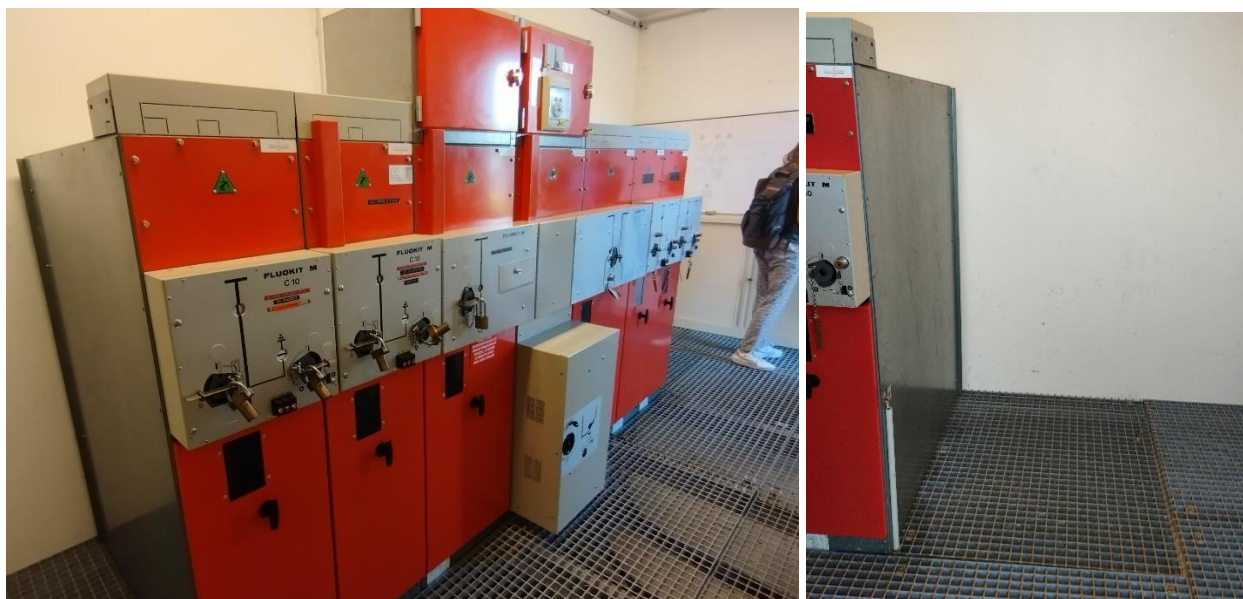
Figure 16 Photographie des cellules HTA au PdL
