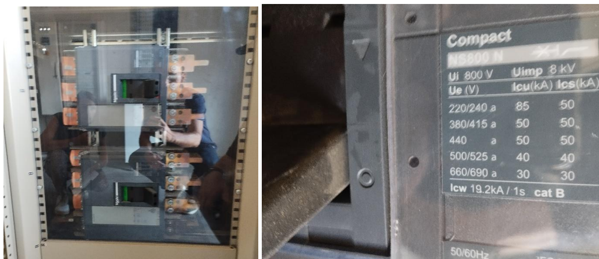
Figure 17 Disjoncteurs laissés libres sur le TGBT 2
