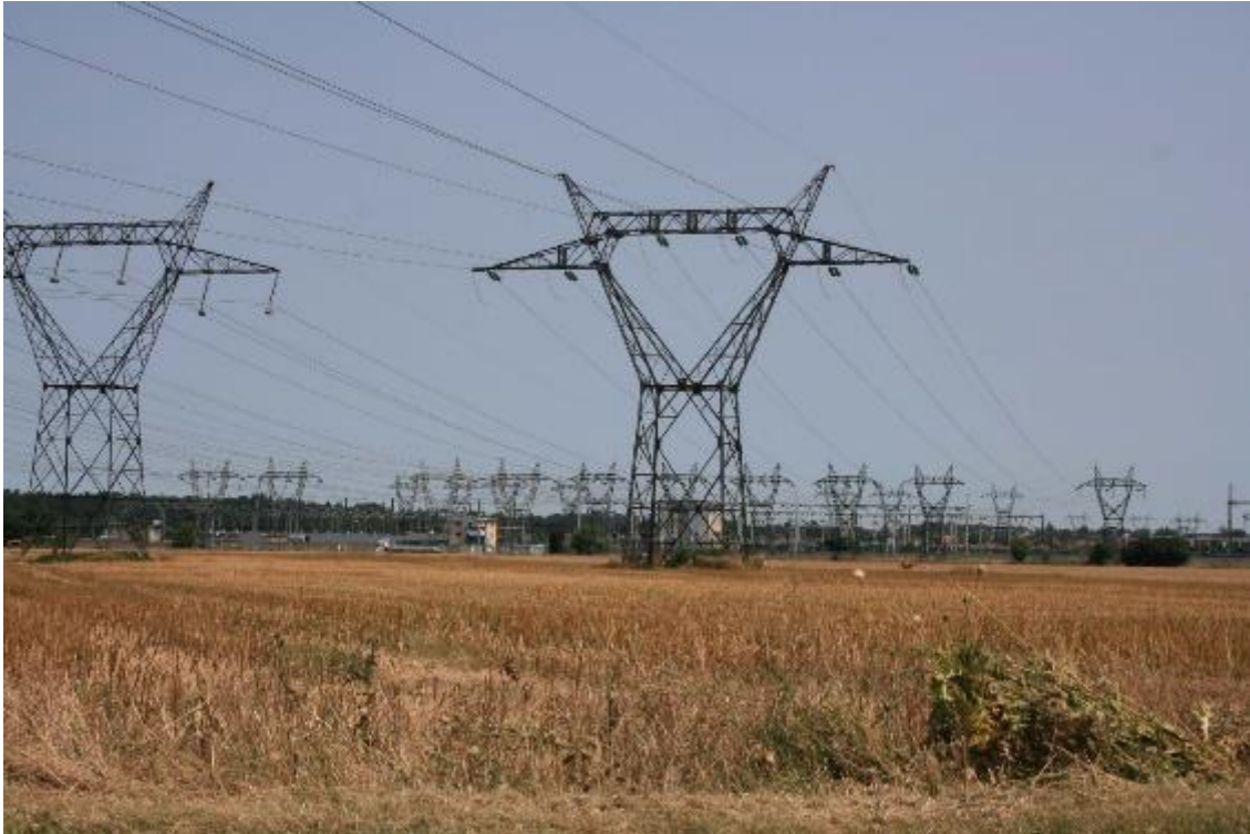
Vue n°7 – Chemin exploitation arrivée au poste électrique de MIONS
