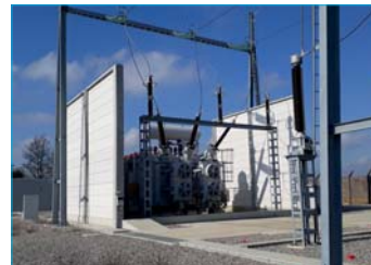
Transformateur avec murs pare-feu
