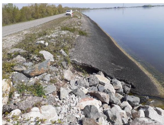
Figure 2 : Morceau de berge endommagé (source : DLE, VNF 2021)
