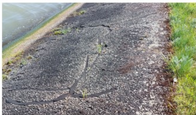
4. Dégradation de berge aval
