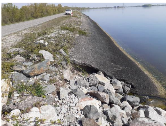
Figure 10 : Morceau de berge endommagé (source : DLE, VNF 2021)
