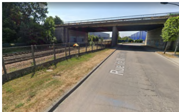
Repérage du tracé de la conduite de gaz en traversée sous la RN4 puis sous la voie ferrée
