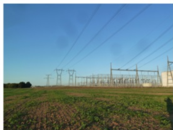
Photo 5 : Poste de ROM avec au premier plan la zone d'extension du poste.
