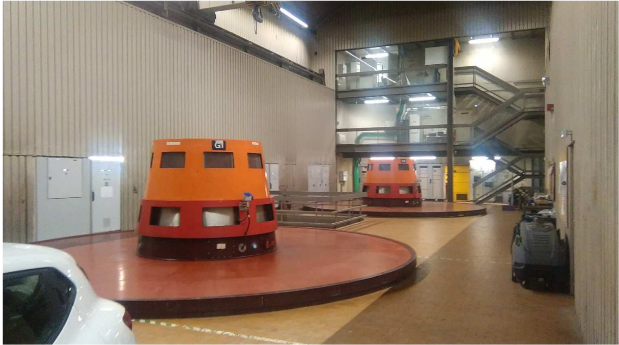
Photo 2 : Intérieur de la centrale souterraine de La Saussaz II (07/2018)
