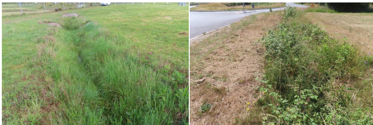
À gauche, fossé végétalisé évacuant les eaux du bassin (en juin) ; à gauche, l'autre fossé à l'Est coté rond-point (en septembre) © P. Thévenin OGE
