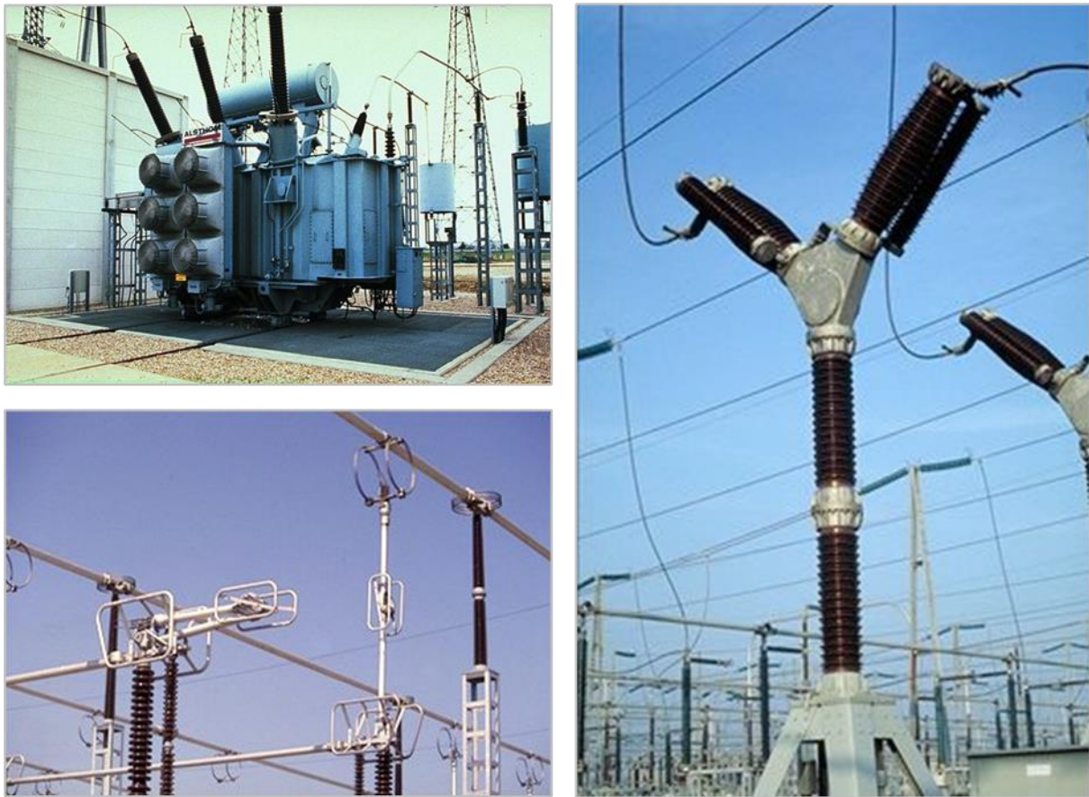
Figure 3 | Exemple de transformateur (en haut à gauche), de sectionneur (en bas à gauche) et de disjoncteur (à droite) d'un poste électrique
