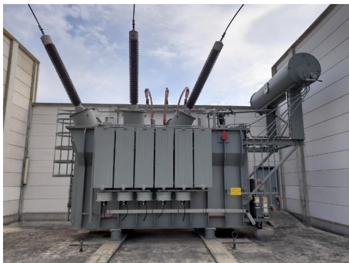
Exemple de transformateur entourés de murs pare-feu
