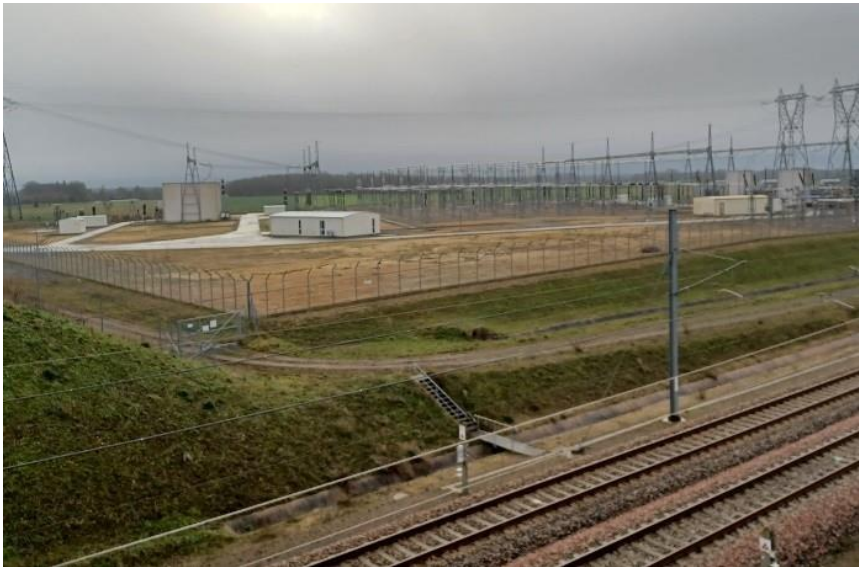
Figure 36 : Vue du poste de ROM et de son environnement (Source : Ing’Europ, janvier 2023)
