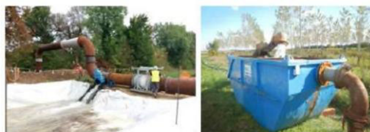
Exemple de bassins de décantation
