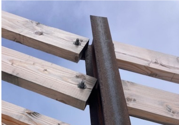
Figure 6: Exemple d'un assemblage non optimal du fait d'une pente en long trop importante. Le contact entre la traverse bois et le poteau est limité et non conforme aux hypothèses de la note de calcul du constructeur. (La Pierre Saint Martin – Dispositif NGE réalisé en 2023 – RTM).
