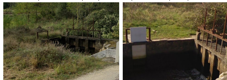
Ouvrage hydraulique infranchissable – Craste de Nézer – Amont D650 (Source : Google Street)
