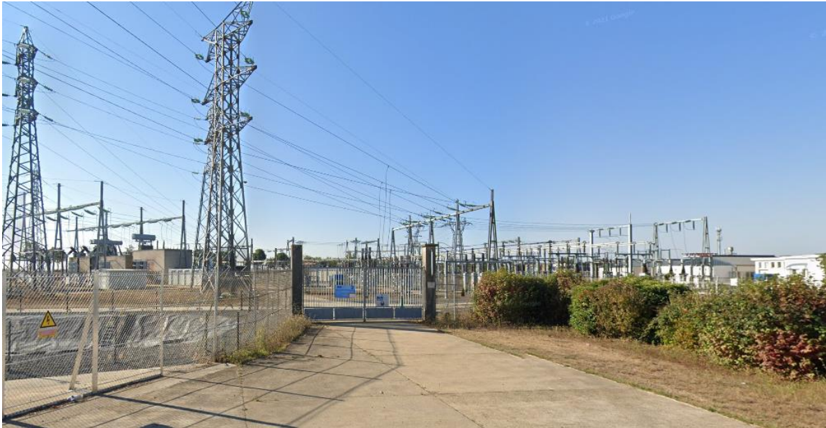
Figure 19 : Photographie de l'entrée du poste d'AIRVAULT (Source : Google StreetView)
