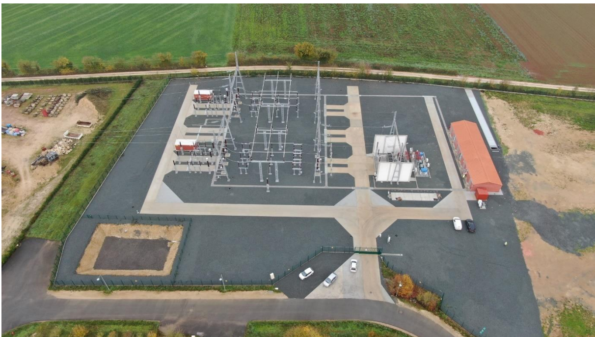
Figure 8 : Exemple d'un poste 225 000/20 000 volts (Source : Gérédis)
