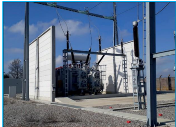
Figure 9 : Transformateur dans un poste très haute tension
