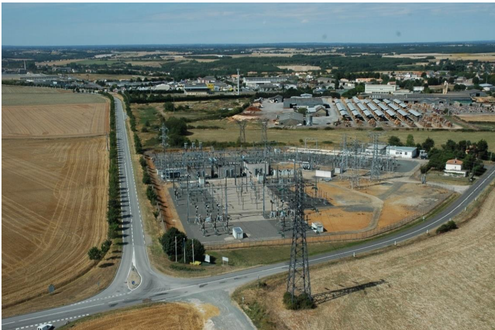
Figure 20 : Photographie du poste d'AIRVAULT en vue aérienne (Source : RTE)
