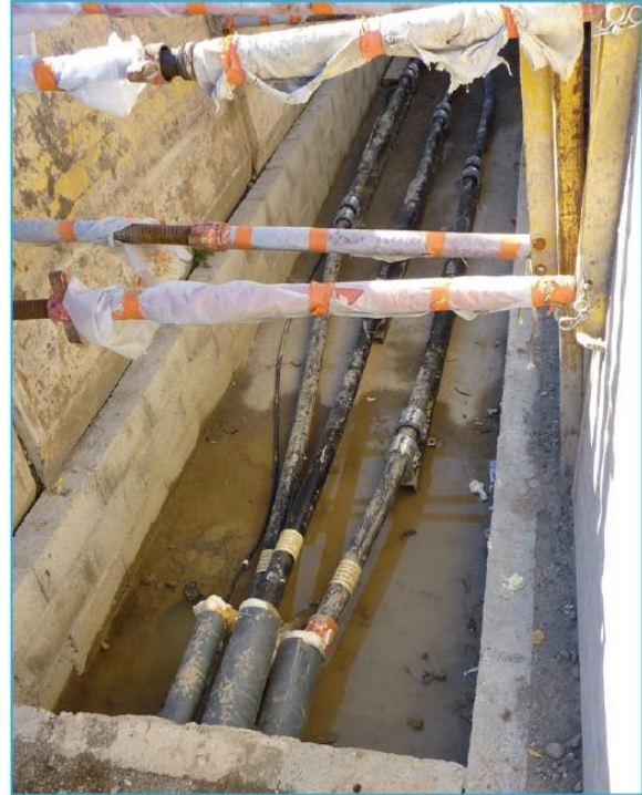
Jonction des câbles dans la chambre
