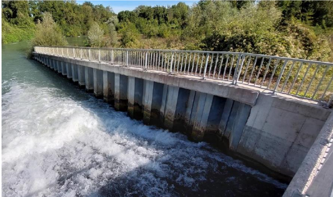
Figure 9 : Rideau de palplanche existant en aval rive droite de l'ORD (Source : BRL Ingénierie)
