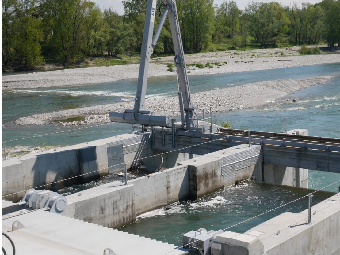
Figure 1 : Centrale VLH de Bisnate en Italie (2 turbines VLH)
