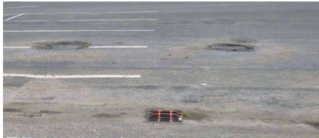
Grille d'eaux pluviales sur un parking (SEGI)
