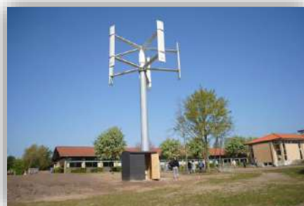
Éolienne Darrieus de 6 kW
