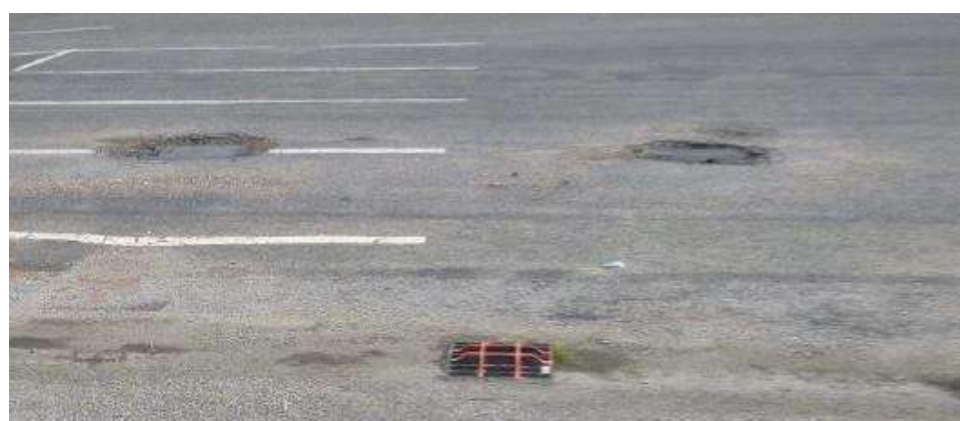
Grille d'eaux pluviales sur un parking (SEGI)
