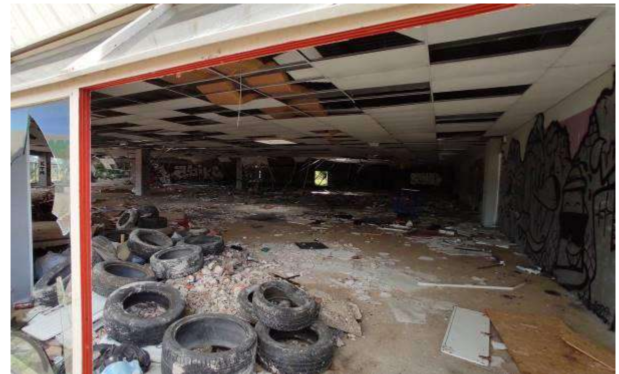
Val d'Ezanville – coque dégradée (MEDIATERRE Conseil)
