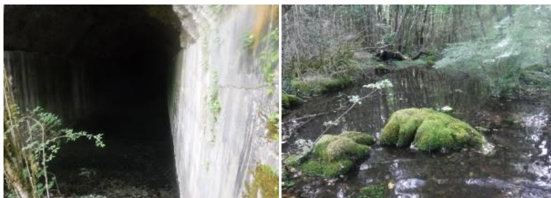
Figure 166 : Zone en eau sous le tunnel de Saut-Mortier (à gauche) et étendue d'eau forestière sur la zone 2 (à droite)
