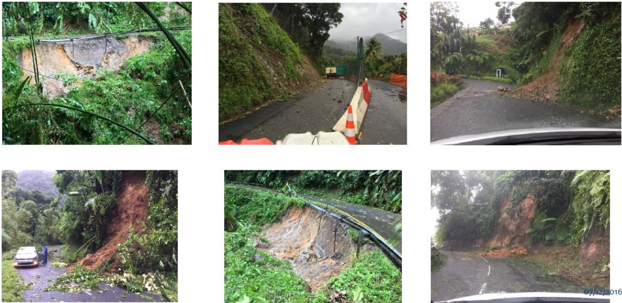
Figure 40 : Photos des dégâts observés sur la RD1 au niveau de Pont Colas à Fonds-Saint-Denis
