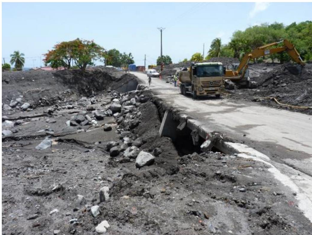
Figure 34 : Vue aval du pont du Prêcheur montrant les dégâts occasionnés à la structure
