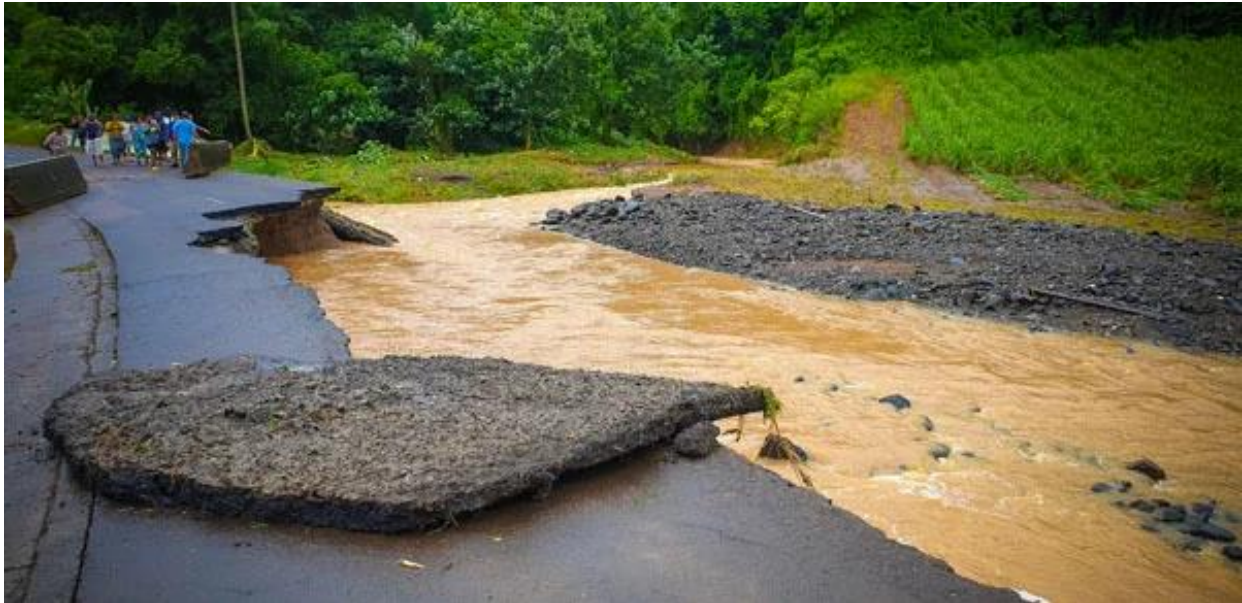
Figure 48 : Affaissement de chaussée à Rivière-Pilote
