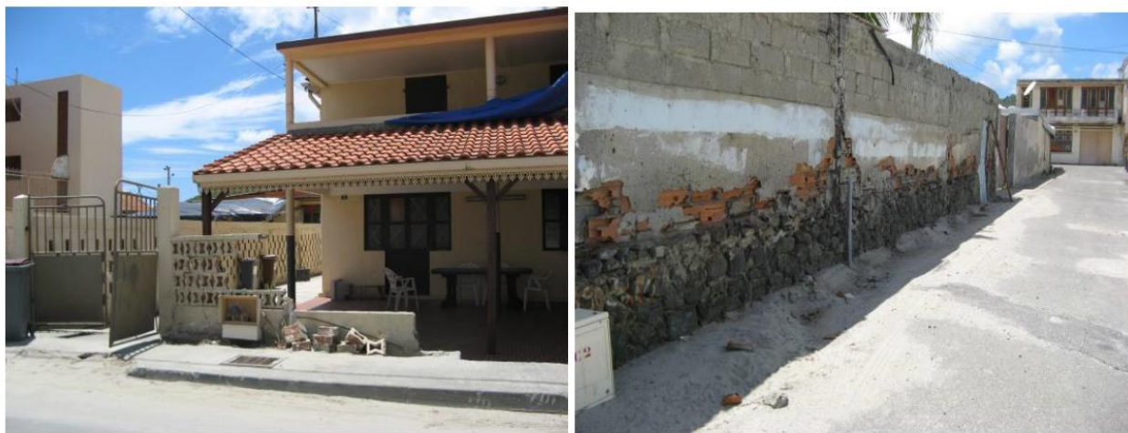
Figure 25 : Au Vauclin, mur en partie détruit par les vagues et traces de dépôts de sable dans les rues. La submersion a été importante et a atteint le centre du bourg, laissant sur place une épaisseur importante de sable dans les rues.
