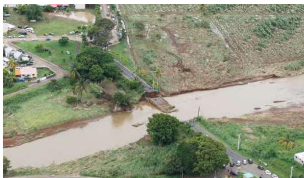
Photo 4: Destruction du pont de Sainte-Claire sur la commune de Goyave (RD33) suite à la tempête Fiona
