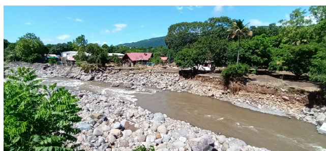
Photo 5: Destruction des enrochements de berge et dégâts sur la zone d'activités située en rive droite de la Grande rivière de Vieux Habitants après la tempête Fiona
