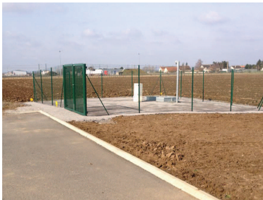
Présence d'un poste de relèvement Eaux Usées en limite sud du site n°1
