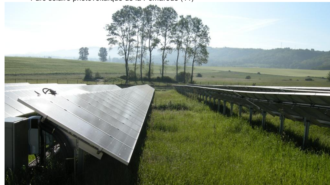
Parc solaire photovoltaïque de la Pomarède (11)
