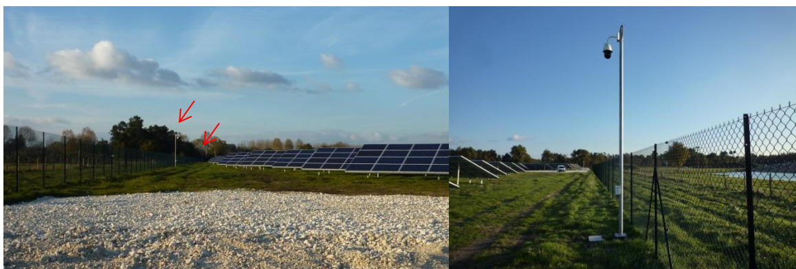
Parc photovoltaïque de Saint-Aubin-De-Blaye (33)
