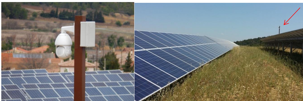
Parc photovoltaïque de Thézan-les-Corbières (11)
