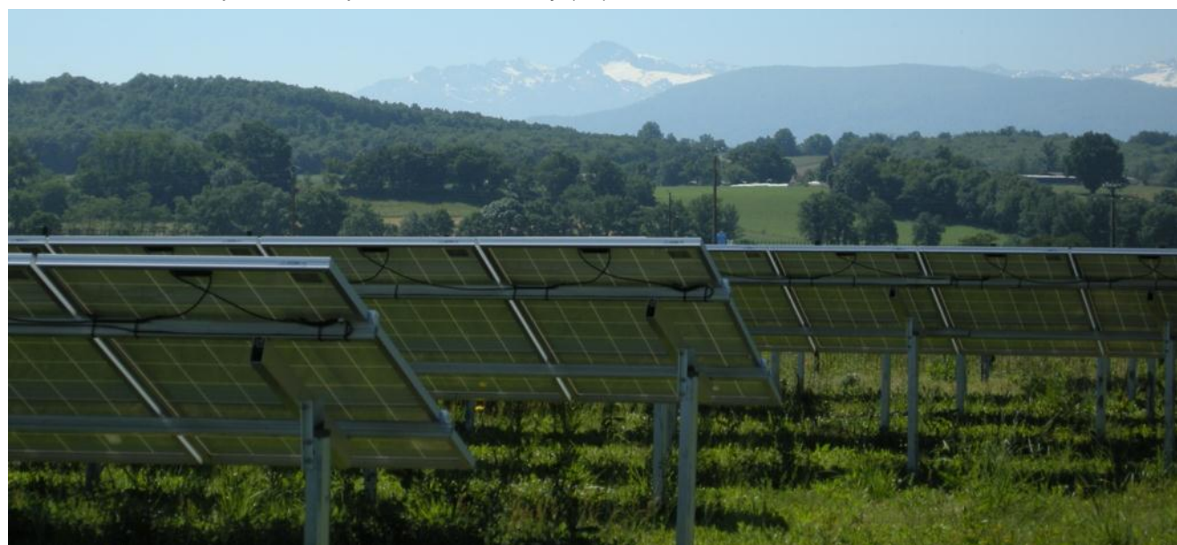
Parc solaire photovoltaïque de Saint-Martory (31)
