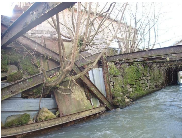
Figure 4 : Instabilité des berges de la Blette à l'amont du ROE 101510
