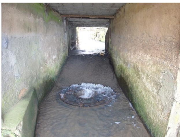
Figure 10 : Section gauche du ROE 101510
