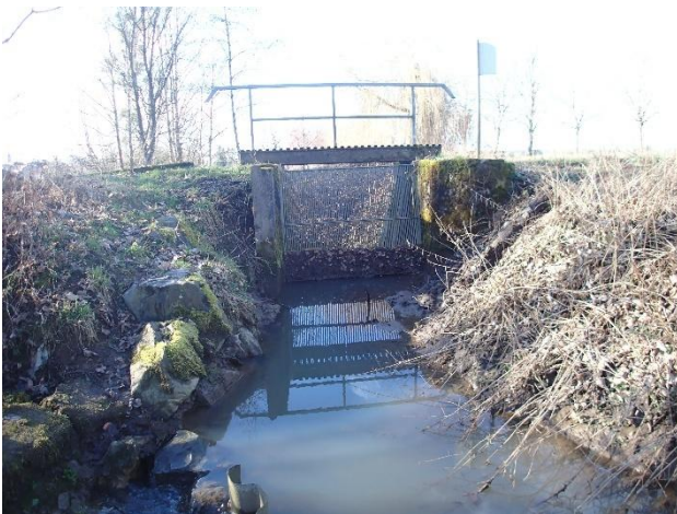
Figure 6 : Prise d'eau passive de l'étang - Vue vers l'étang
