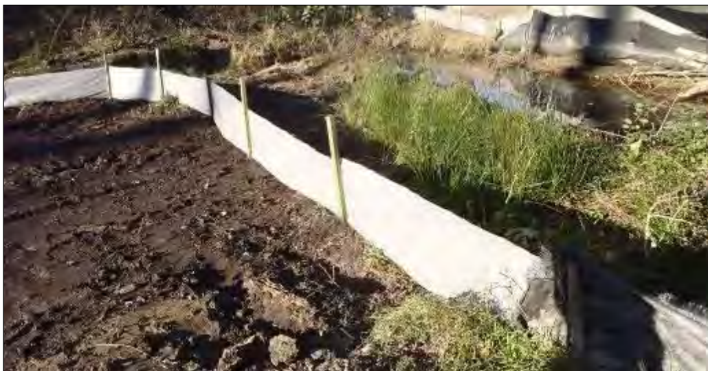
Implantation de barrières amphibies en géotextile permettant d'éviter les déplacements des individus du cours d'eau vers le chantier © ETEN Environnement
