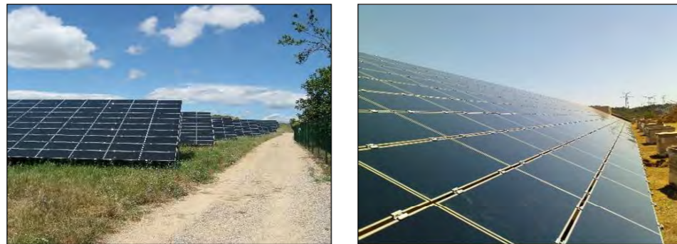
Panneaux solaires Source : EDF Renewables
