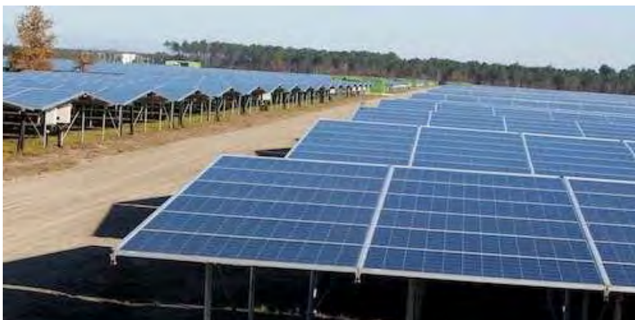
Disposition espacée des modules sur une table (source : NEOEN)
