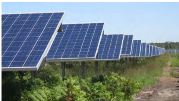
Développement de la végétation sous les panneaux (source : NEOEN)
