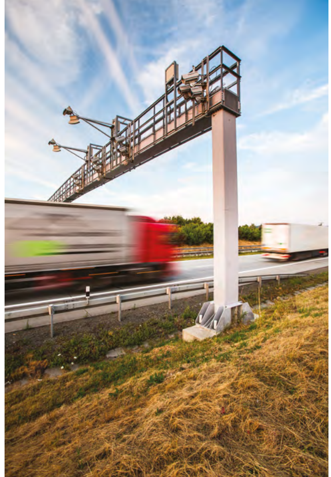
Exemple de portique utilisé pour un péage à flux libre
