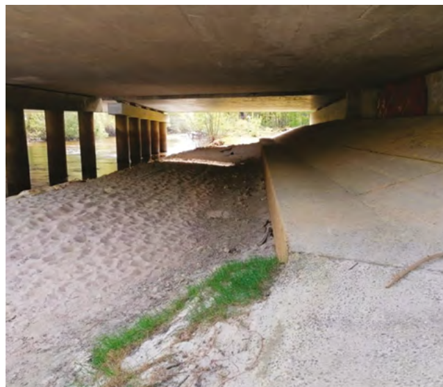
Passage grande faune et banquette au niveau de l'ouvrage de franchissement de l'Eyre
