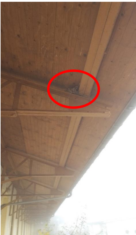
Figure 19 : Nid d'oiseau sous avancée de toiture du bâtiment 016 en février 2025 (Olivier SAINT-JOURS)
