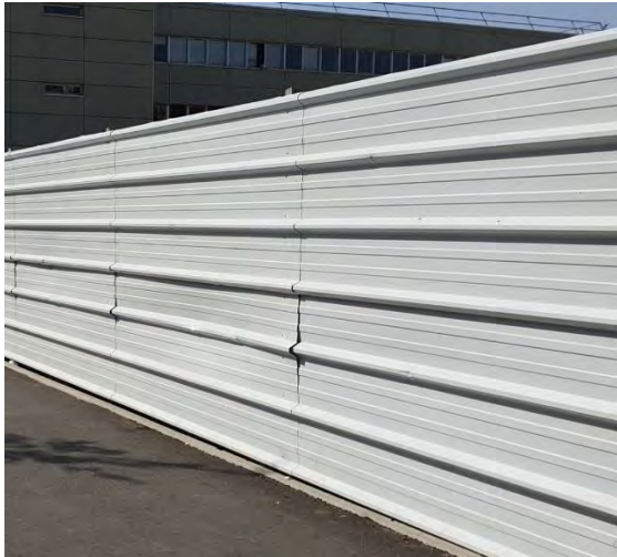
Figure 69 : Clôture pleine de chantier
