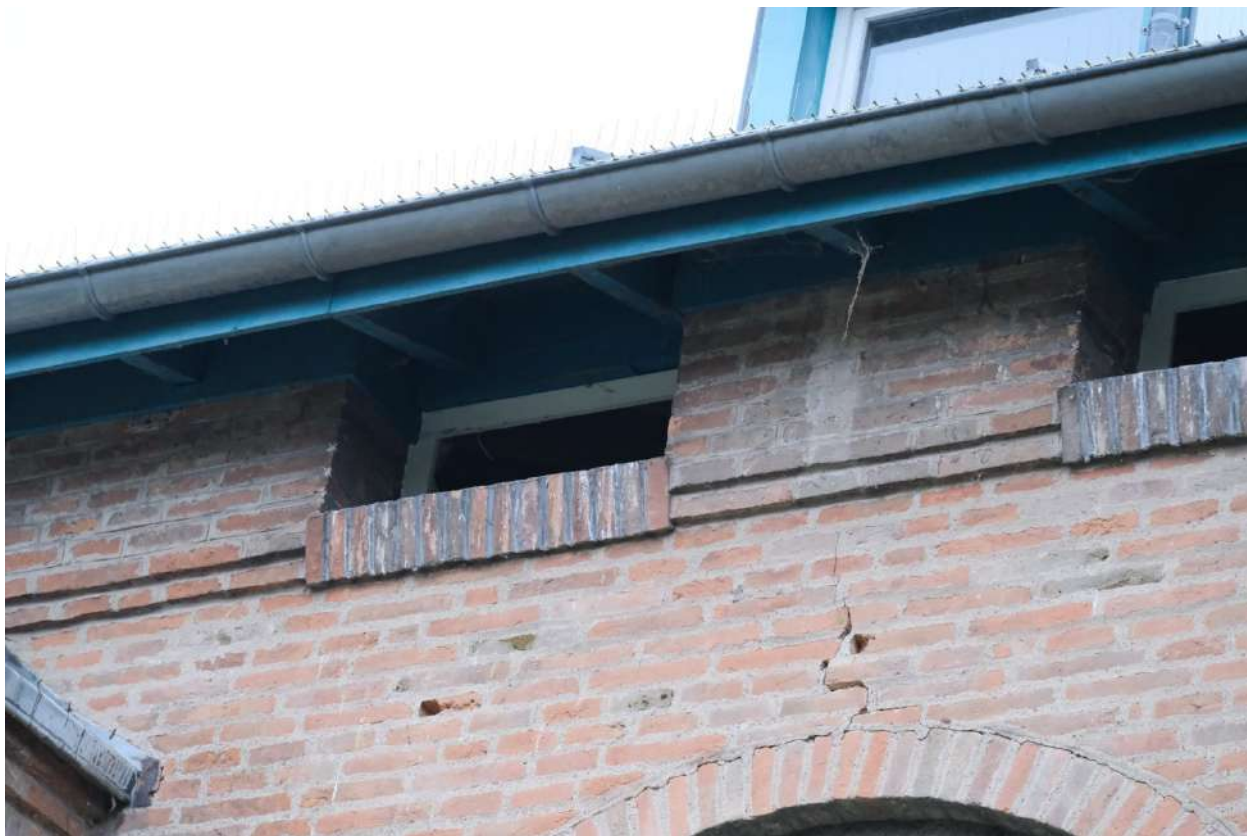
Illustration 26 : Rebords de fenêtre sans pics anti-oiseaux et traces de fientes – Source ARCHIMED Environnement
