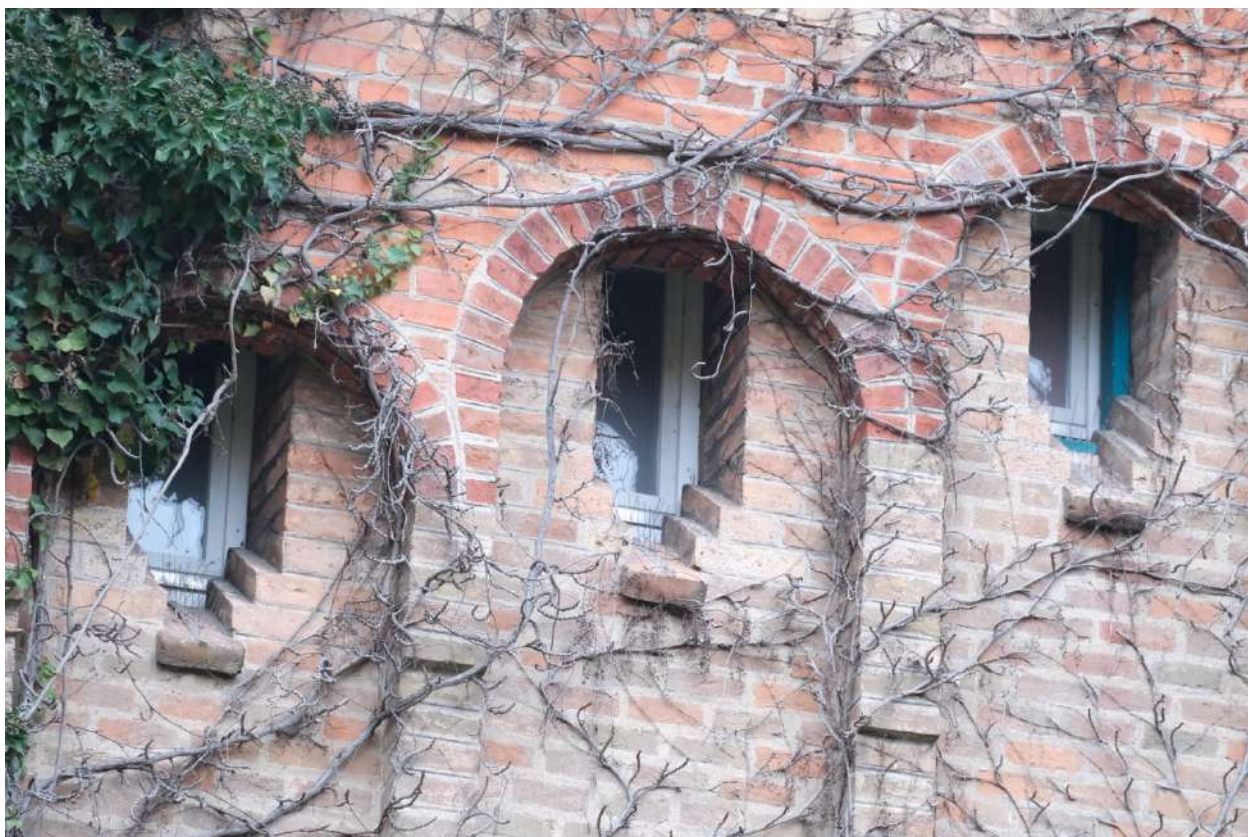
Illustration 25 : Rebords de fenêtre avec pics anti-oiseaux – Source ARCHIMED Environnement
