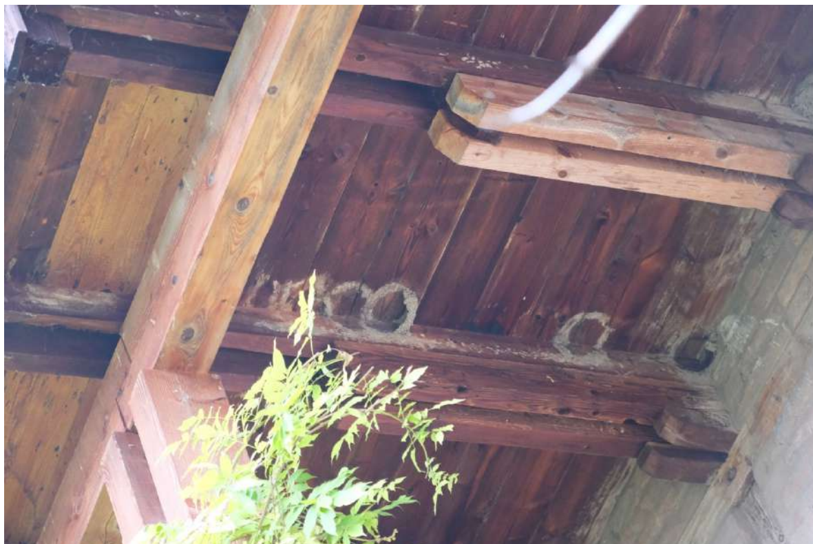
Illustration 35 : Traces de nids d'hirondelles de fenêtre sur l'une des façades du bâtiment du restaurant avant travaux – Source ARCHIMED Environnement
