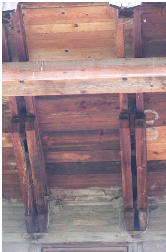
Illustration 34 : Nids d'hirondelles de fenêtre sur l'une des façades du bâtiment du restaurant avant travaux – Source ARCHIMED Environnement
