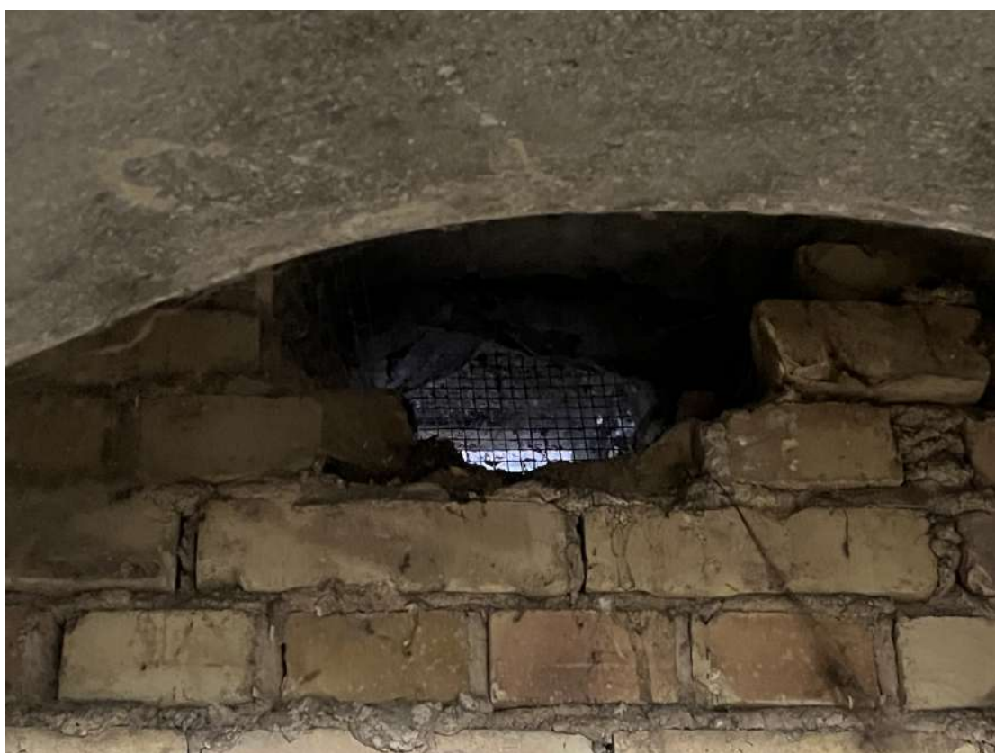
Illustration 23 : Fenêtre grillagée à l'intérieur – Source ARCHIMED Environnement
