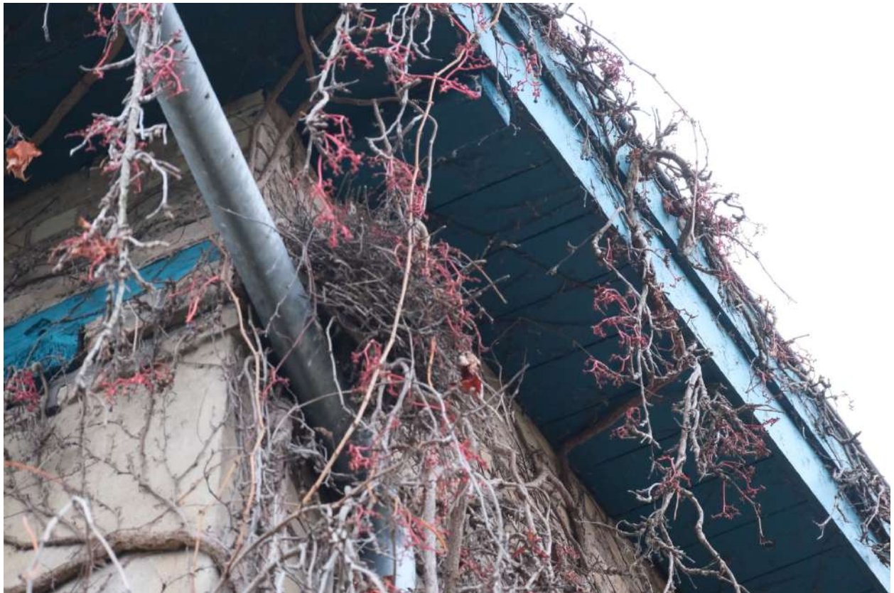
Illustration 29 : Nid de passereau sur la façade Sud du château – Source ARCHIMED Environnement
