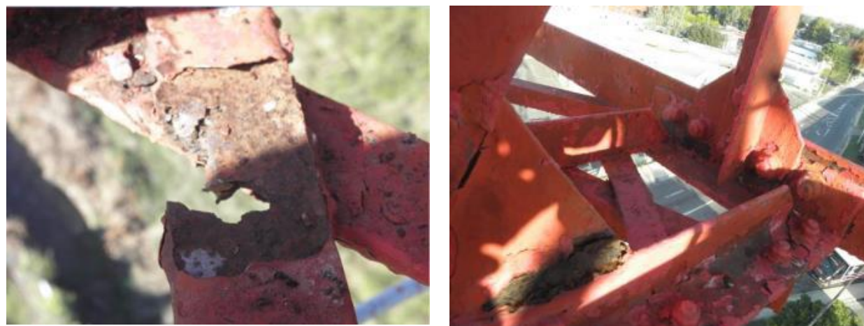
Figure 15 : Exemples de pylônes soumis à l'érosion
