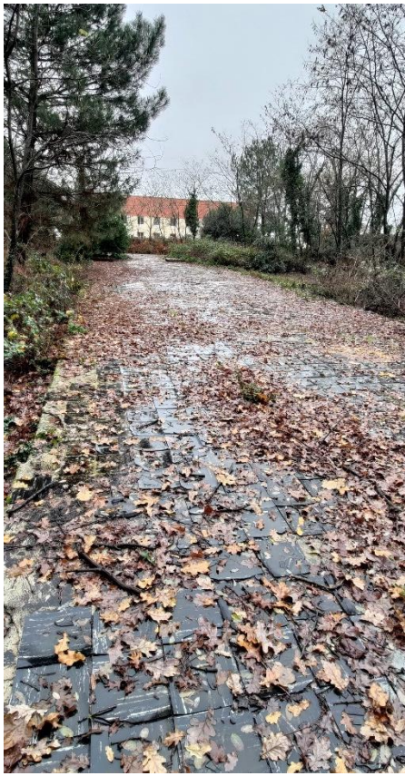
Dalle amiantée (ancien bâtiment) au sein de la chênaie, EGIS, 12/2023
