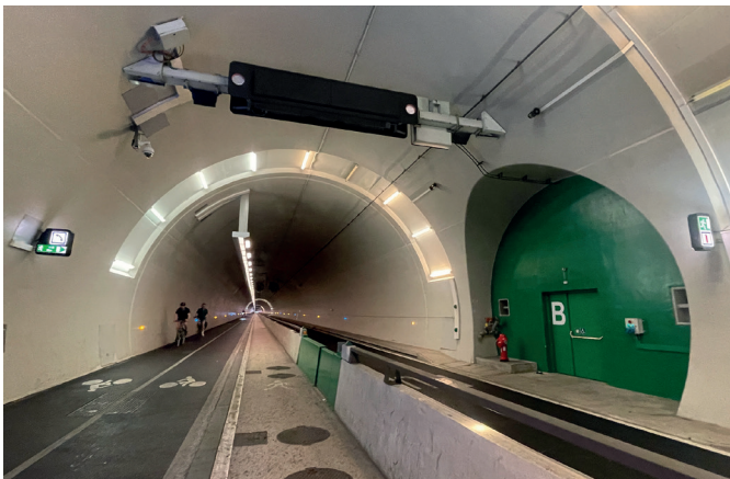
Issue de secours – Tunnel modes doux de la Croix-Rousse (© CETU)
