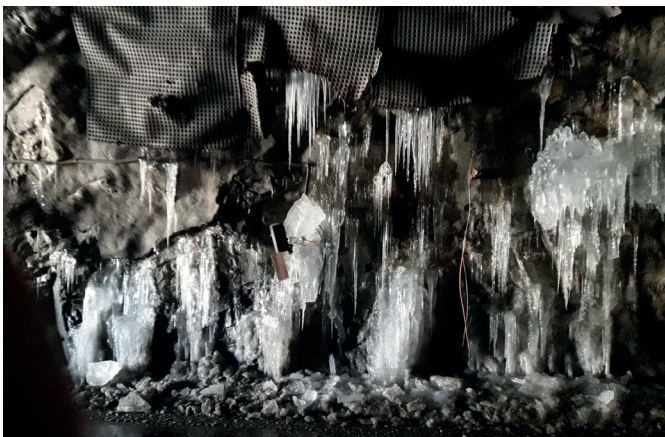
Formation de glace sur les équipements du tunnel du Chevril Hiver 2023/2024 (© CD73)
