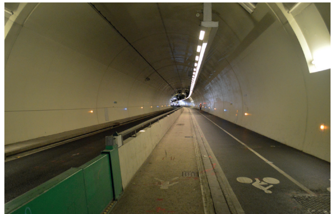
Glissière mobile – Tunnel modes doux de la Croix-Rousse (© CETU)
