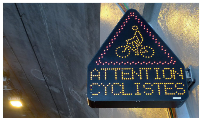
Panneau présence cycliste allumé après détection (© CETU)
