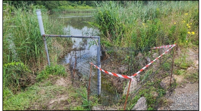
Barrière anti ponte sur le bassin est
