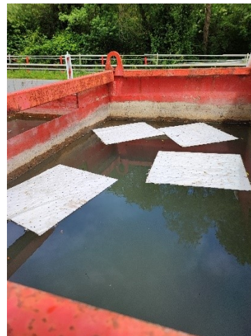
Exemple de bac de décantation avec buvards anti-pollution, en prévention
