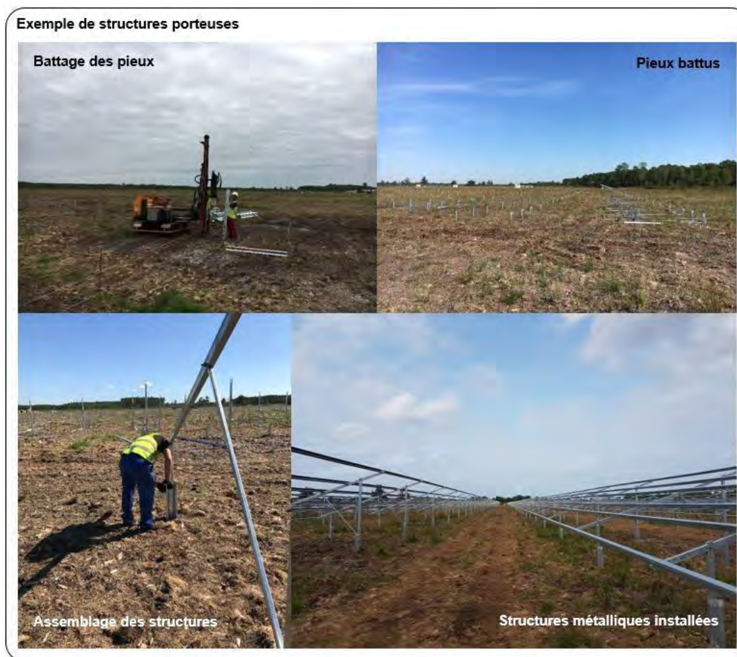
Figure 44 : Structures porteuses métalliques (Source : BayWa r.e.)
