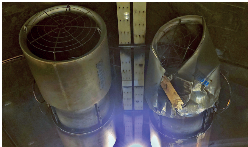
Domage à un accélérateur dans le tunnel de Ponsérand.
