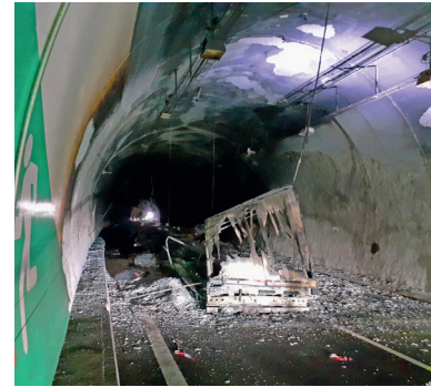
Le tunnel du Vuache suite à l'incendie d'un poids lourd en juin 2025.
