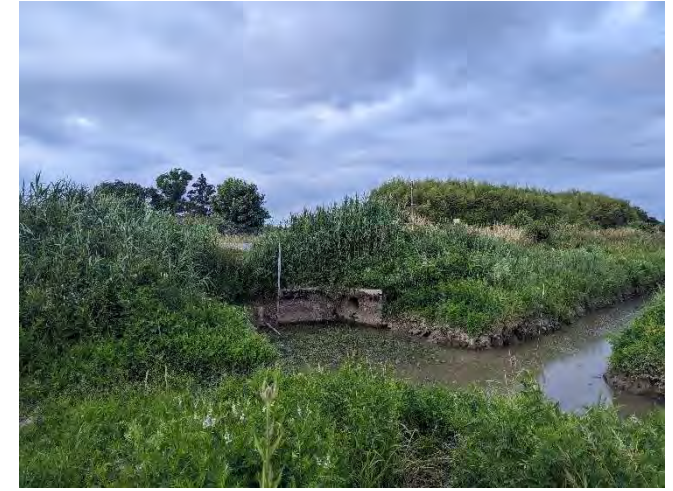
Clapet obstacle à la continuité vers les barthes de Lahonce de l'autre côté de la D312
