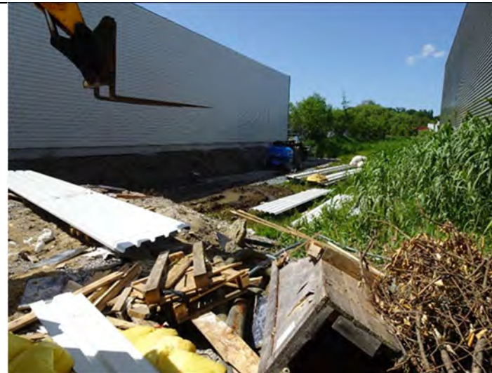
Déchets et stockage matériel qui s'étend sur zone humide – Sud du secteur 5
