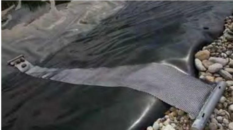
Echappatoire mis en place sur un bassin en géomembrane (Source : Département de l'Isère)
