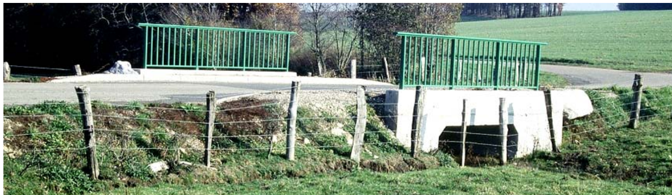
Des ouvrages de médiocre qualité architecturale, aux abords dégradés.
