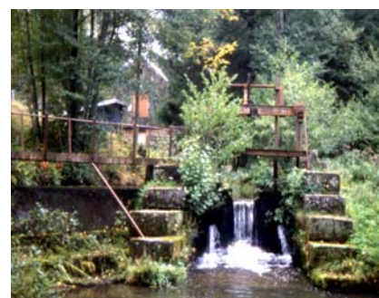
Les anciens ouvrages hydrauliques ne sont plus entretenus.
