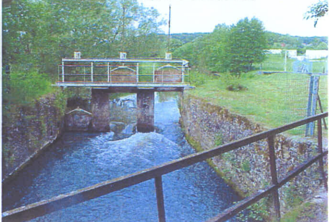
16 - vannes à la Grange aux Bois
