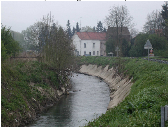
Photo 1 : seuil sur l'Hogneau (© Cemagref-Poulard)
