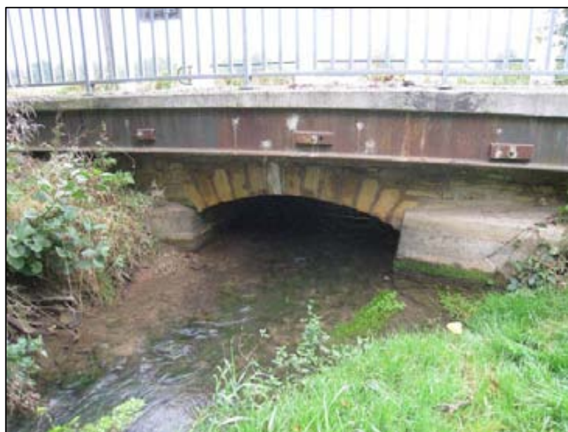
Photo 10 : ruisseau des rejets au droit de la RD 139
