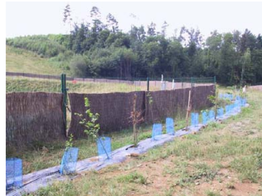
Photo 38 - Exemple de système d'occultation sur un ouvrage spécifique grande faune, cliché EGIS
