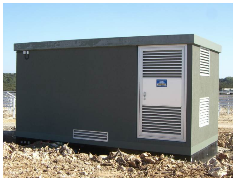
Photo 5 : Illustration d'un système électrique sur un parc photovoltaïque
