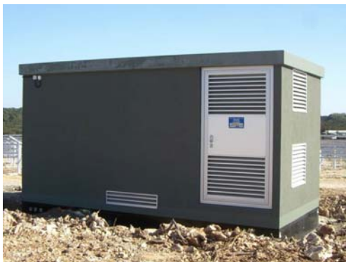
Poste technique du par photovoltaïque voisin de Rochefort du Gard –
