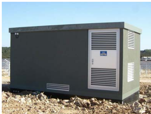
Poste technique du parc photovoltaïque voisin de Rochefort du Gard
