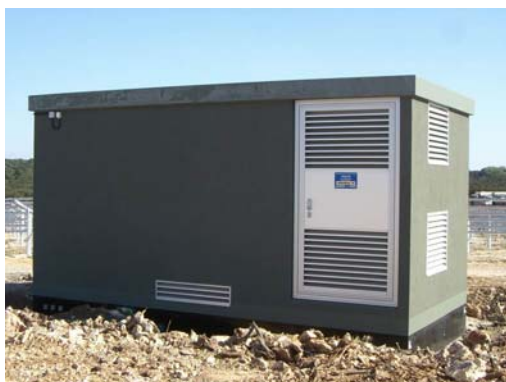
Exemple de couleur d'un poste technique pour le parc photovoltaïque de Rochefort-du-Gard.
