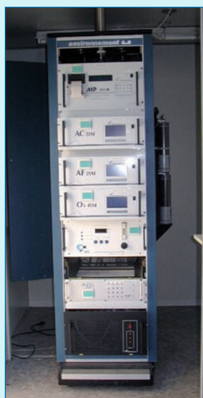
Figure 3 - Baie d'analyseurs en station fixe
