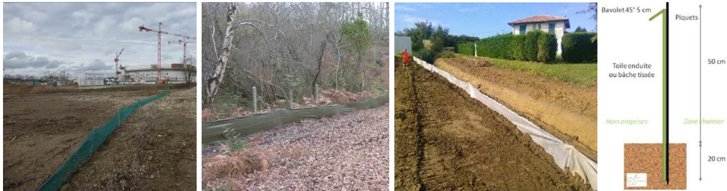
Exemples de barrières anti-batraciens/ systèmes de filtration ceinturant un chantier (Source : Simethis)
